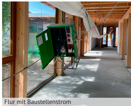
Flur mit Baustellenstrom
