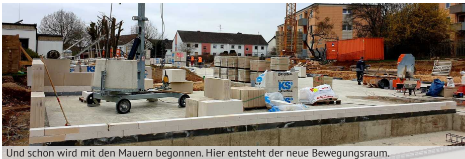
Und schon wird mit den Mauern begonnen. Hier entsteht der neue Bewegungsraum.
